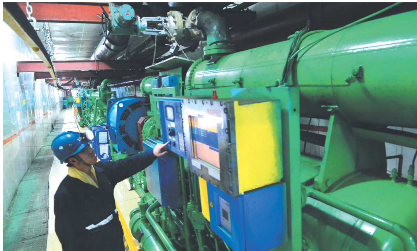
□王世翔 秦军义 报道 山东能源新矿集团新巨龙公司工作人员在巡检操作WAT制冷设备。针对井下高温热害凸显的实际，本着节能、减排、高效的原则，新巨龙公司引进WAT井下集中制冷降温系统，装备9台机组，制冷量达29700kW，形成以“机械降温”为主、“通风降温”为辅、“热源防控、综合治理”相结合的综合降温模式，主要作业地点保持在26℃以下。
