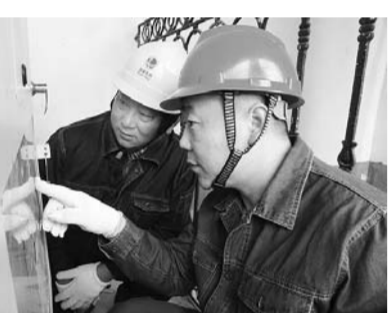
□龙古月 报道 4月27日,国网平邑县供电公司柏林供电所工作人员对国家4A级景区——蒙山旅游景区索道的配电室设备进行了现场检查和维修。为确保五一期间旅游景区安全用电,该公司在节前对全县旅游景区、高危及重要用户开展了电力设施专项隐患排查,全面加强客户用电安全管理,检查督促客户做好电气设备的运维工作,预防和杜绝因客户电气设备引发电网安全事故的发生。
