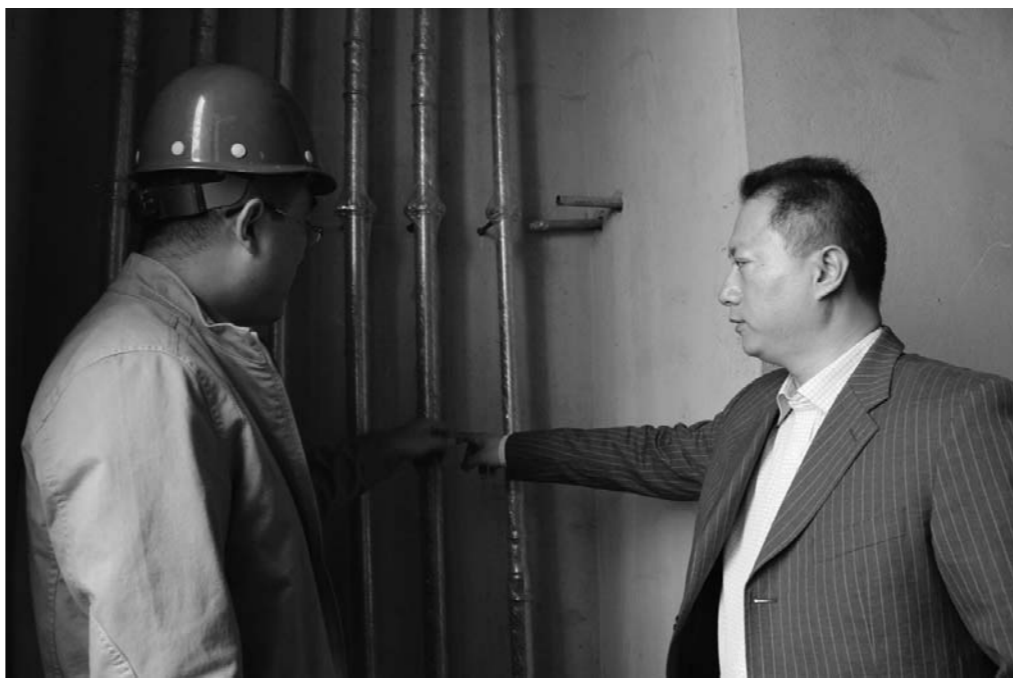
3月24日，李京朋(右一)在张店区房镇镇高北村搬迁房施工现场检查小区直饮水不锈钢管道安装情况。
