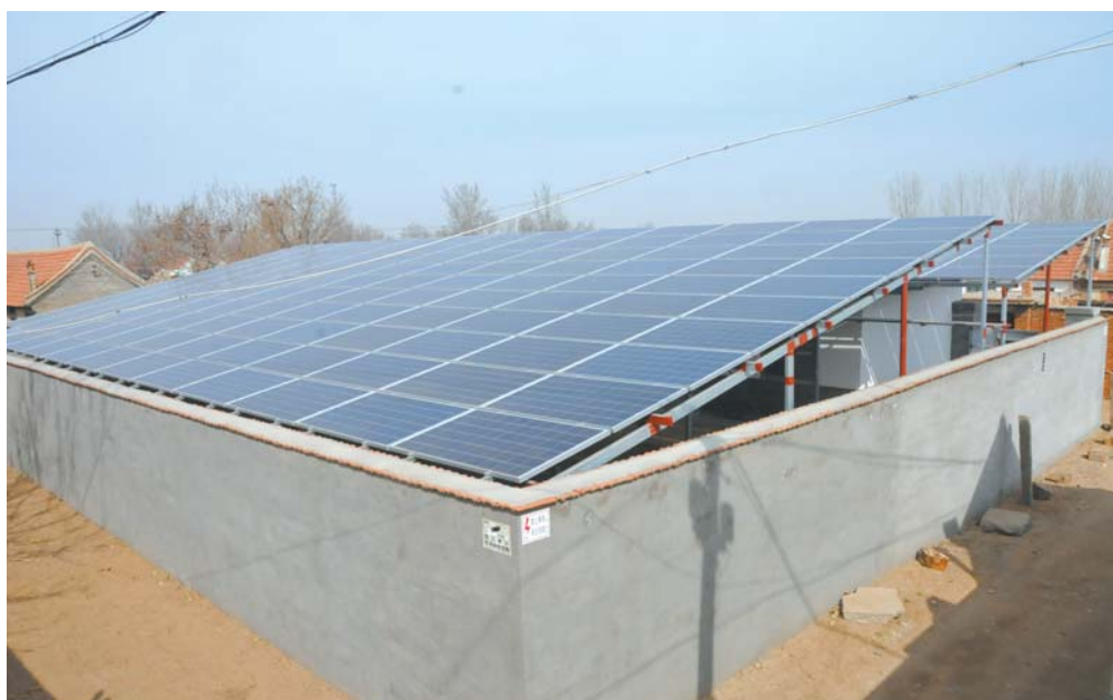
邓旭光安装的光伏发电装置。
