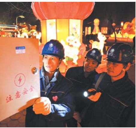
□关键 姜倩 报道 为确保元宵节期间灯会用电安全，国网枣庄供电公司彩虹党员服务队深入全市各商业区、广场对灯展配电设备的运行状况、备用电源配置、花灯供电线路等进行排查，及时消除隐患。 图为3月5日，在枣庄市市中区民俗灯会上，工作人员在检查灯展供电线路。
