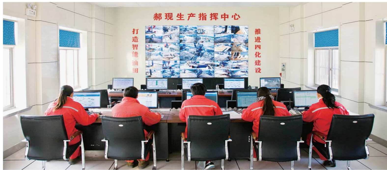
△胜利油田“四化”建设示范区利用视频监控等信息化手段巡查油井
