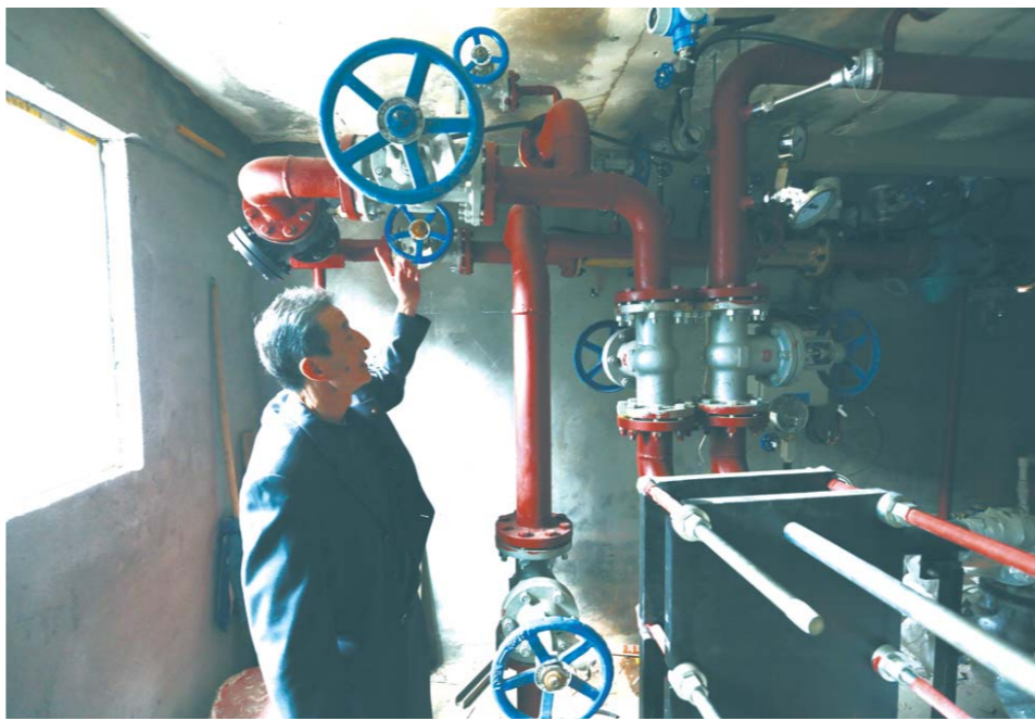
寿光东都小区居民自建的换热站。
