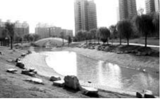
□记者 张宇鸿 通讯员 李建 白聪聪 报道 本报禹城讯 10月17日，禹城市赵徒干渠人工湿地建设现场，工人们正在加紧施工。项目负责人郑磊介绍说：“我们抓住当前有利时机，倒排工期，确保今年11月底项目完工。”
