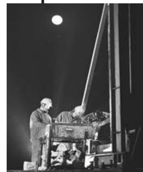
▲借着月光，值班人员对设备进行巡检、维护。
