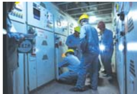
□韩金林 刘珍 报道 ▲8月28日凌晨,国网济南历城区供电公司变电人员汇报35千伏王舍人变电站最后一条10kV出线送出完毕,圆满完成一项零点工作任务。
