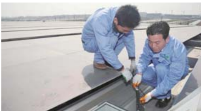
△阳光光伏屋顶发电系统
