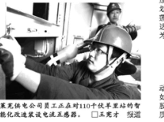
莱芜供电公司员工正在对110千伏羊里站的智能化改造建设电流互感器。
