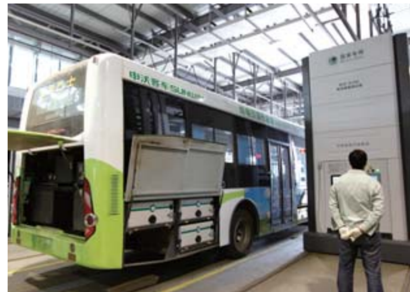
▲自动换电设备为电动公交车进行电池更换
